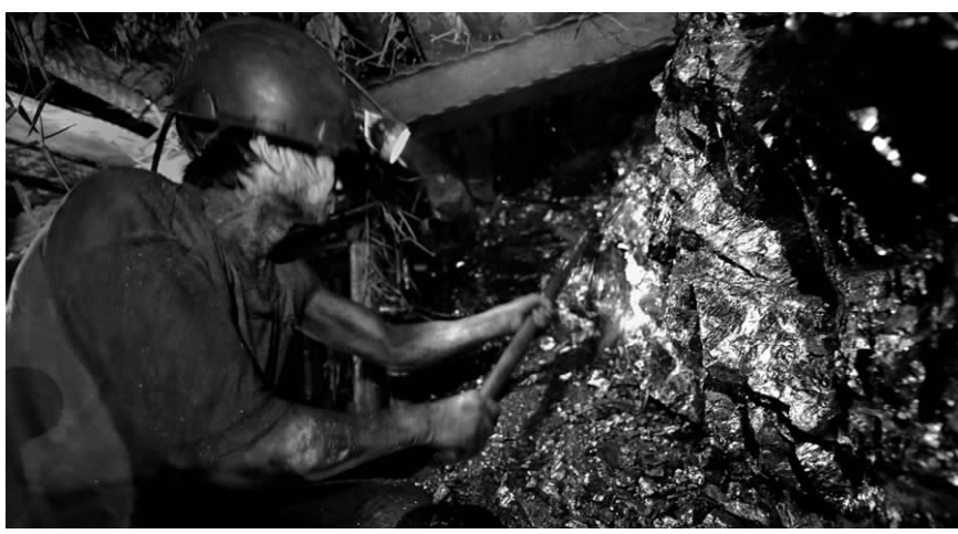
部分煤矿建设项目现场隐患排查治理不深入,技术管理、现场管理有薄弱环节。
