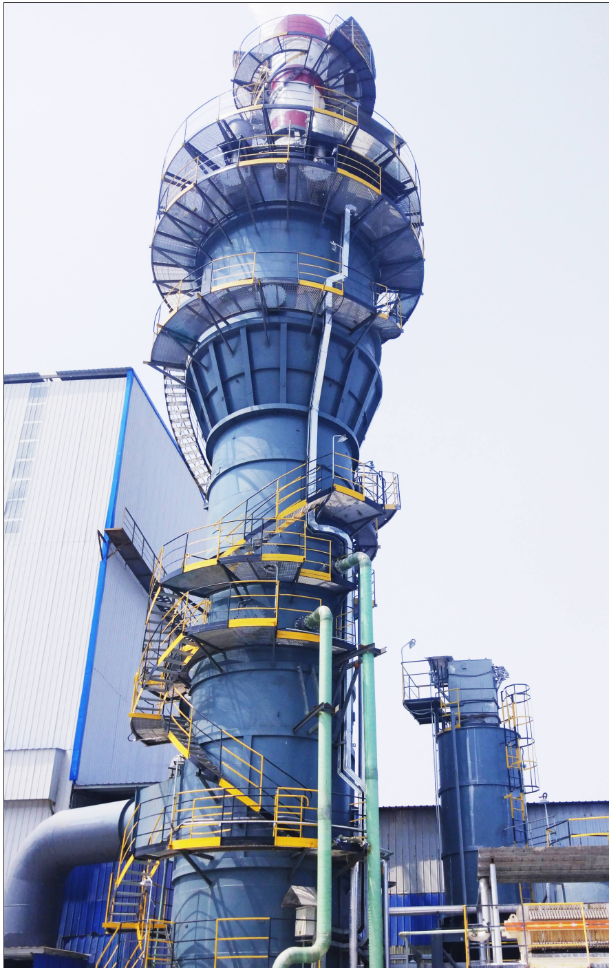
图为科行环保在淄博天佳陶瓷脱硫湿电一体化超低排放工程。
