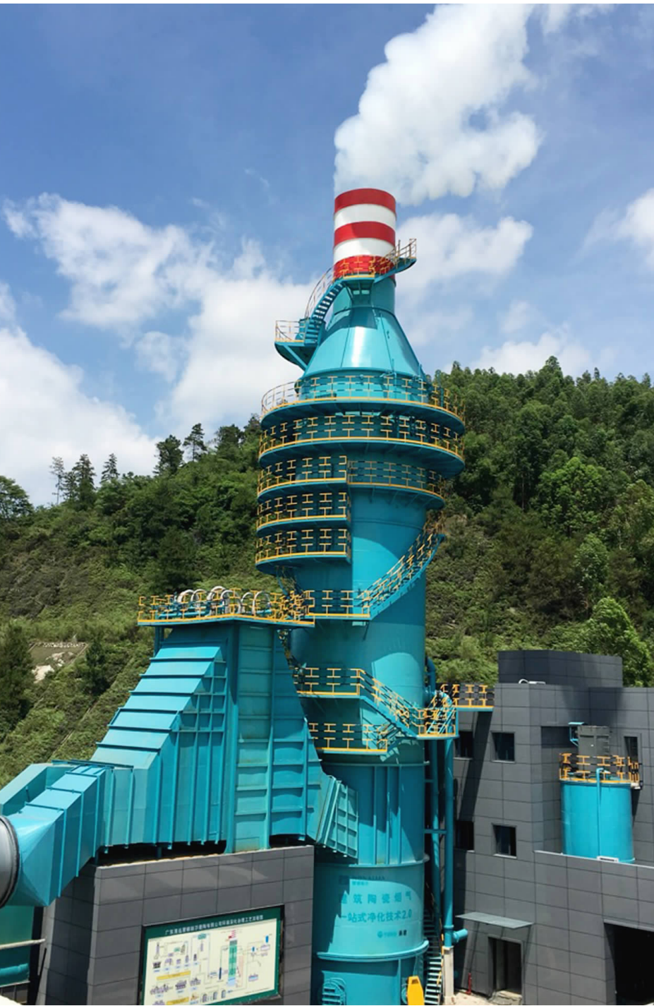
广东清远蒙娜丽莎建陶有限公司石灰石-石膏法脱硫项目,达到超低排放水平。
